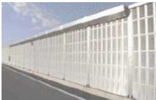
壁の上部にあるのがアクティブ減音装置(アクティブソフトエッジ遮音壁)
