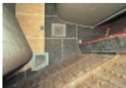
ストーカ炉内部の様子
