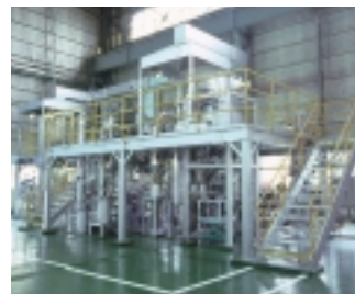
バイオマスガス化メタノール製造プラント
