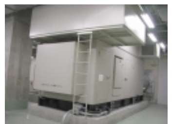
コージェネレーション設備
